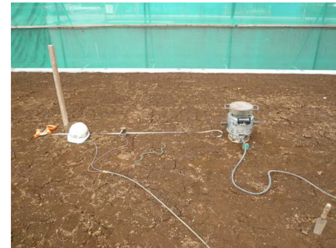
M様邸新築工事 地盤調査の状況です。2世帯住宅を新築します。 数ヶ月かかりますので、見学会は来年の予定です。
